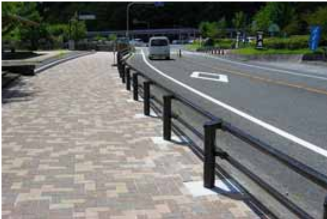
写真 2.3.3 景観ガードパイプ（二連）
